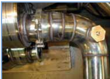
Abbildung 16 Rauchanschluss am Einlassrohr
